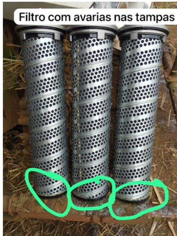
Figura 5: Elementos filtrantes danificados;
